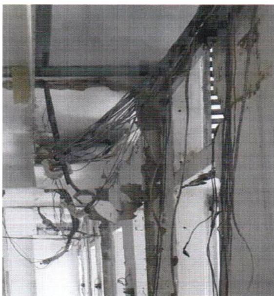
Foto 06 - Fiação antiga da obra.
